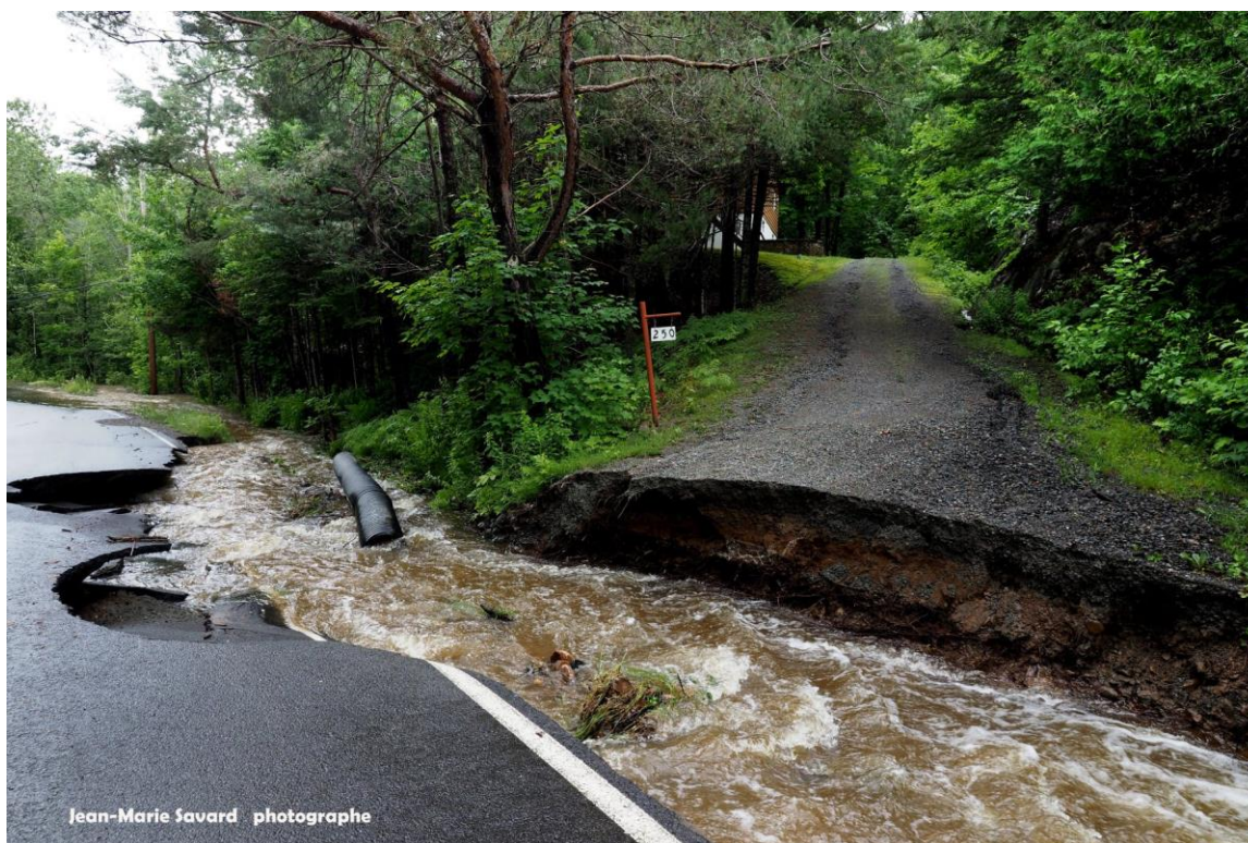
Figure 26 : Exemple de dommages aux infrastructures routières sur le territoire de la Ville de Mont-Tremblant et la Municipalité de Lac-Supérieur, 30 juin 2021
